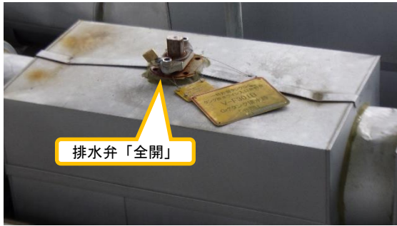
(写真2-3) グループ2排水弁の「全開」状況
