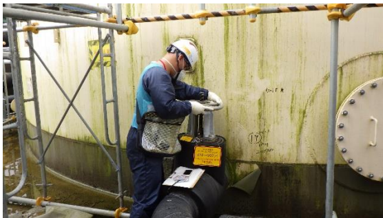
(写真6-1) タンク (F) の出口弁「開」操作状 況
