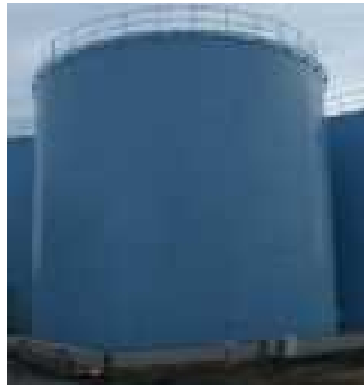
溶接型タンク
