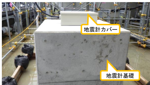
(写真7) 新地震計の設置状況（北側から撮影）
