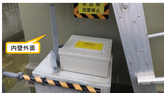
(写真9) 既設地震計の状況（エリア西側を西側 から撮影）
