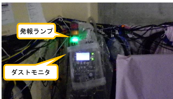
(写真4-1) ダストモニタの設置状況 (1階用)
