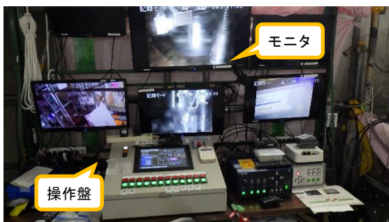
(写真1) 遠隔操作室内の状況
