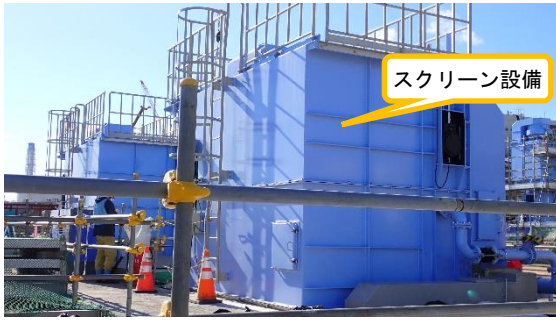
(写真1-1) 新設されたスクリーン設備
