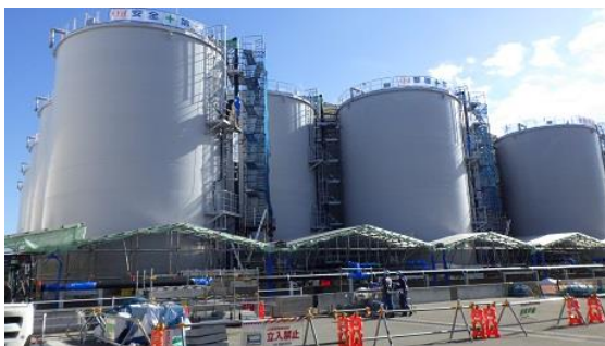
(写真1) K4タンクエリアの概観
