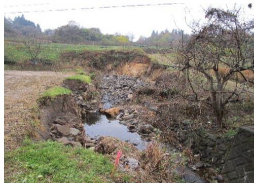
梅ノ木沢堰第1(被災状況)
