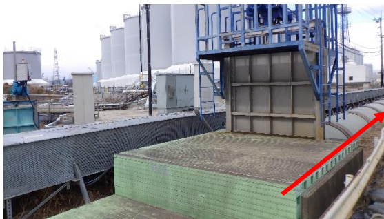
(写真 3 - 1) 排水路に設置されている電動ゲートの例 (写真はB排水路のB-1。赤矢印は排水が流れる方向を示す。)
