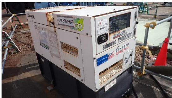
(写真2-2) 発電機の状況
