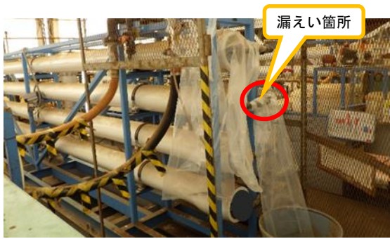
(写真 2 - 1) 漏えい箇所 (逆浸透膜出口配管) の 状況
