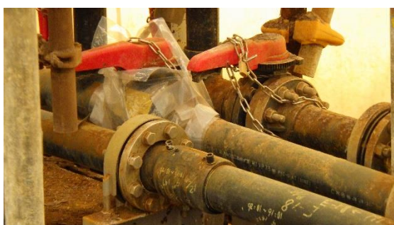
(写真5-2) 出口弁の状況②
