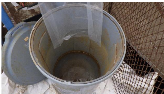
(写真 2 - 2) 漏えい水受け (プラスチック製バケ ツ) の状況
