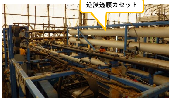
(写真1-2) RO-3逆浸透膜スキッド2の概観
