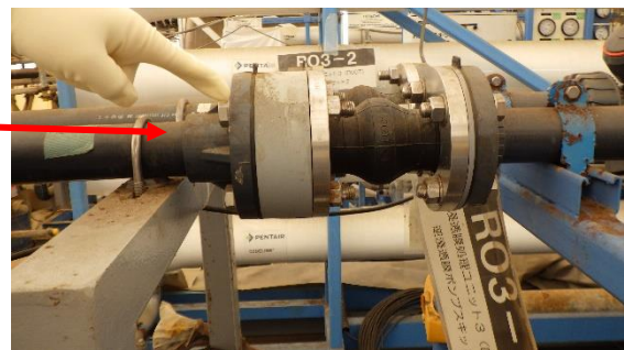
(写真 3 - 2) 漏えい箇所 (配管フランジ部) の状 況②
