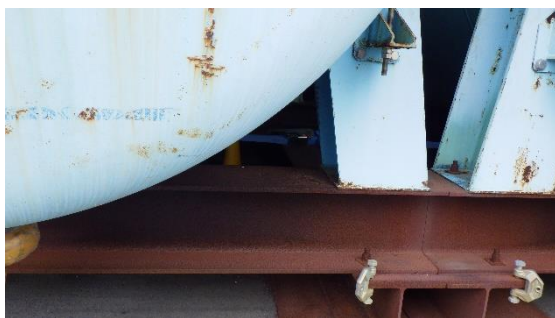
(写真2-1) タンクと台座等の固定の例① (ブルータンクエリアC)
