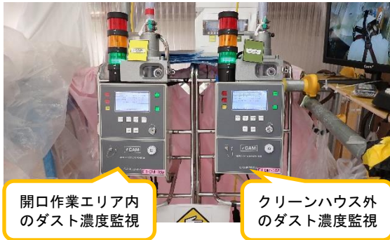
(写真3) 連続ダストモニタの稼働状況
