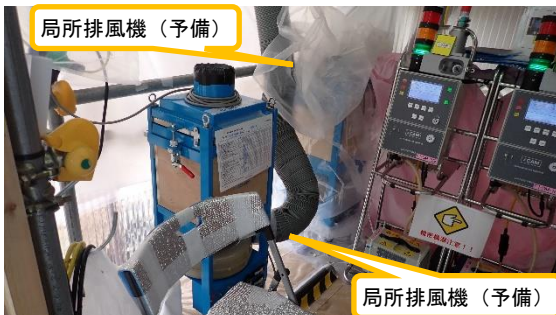
(写真2-2) 予備の局所排風機の配備状況
