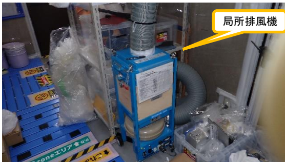
(写真2-1) PMB内に空気を押し込む局所排風機の設置状況
