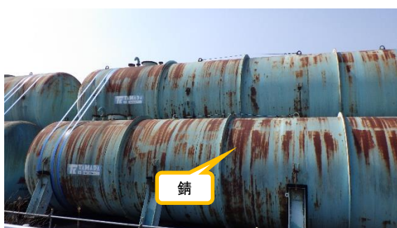
(写真3-1) ブルータンク表面の劣化状況の例
