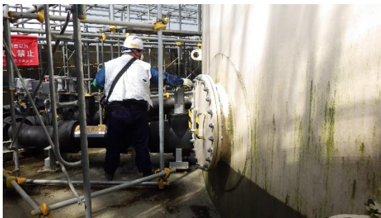
(写真5-1) 排水しない一時貯水タンク（J）の 出口弁の状態（「全閉」）確認状況
