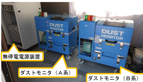
(写真1-2) 小屋内の構内ダストモニタ設置状況 (正門警備所前)
