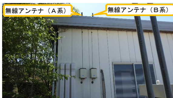
(写真 3) 無線アンテナの設置状況 (シールド中央制御室)
