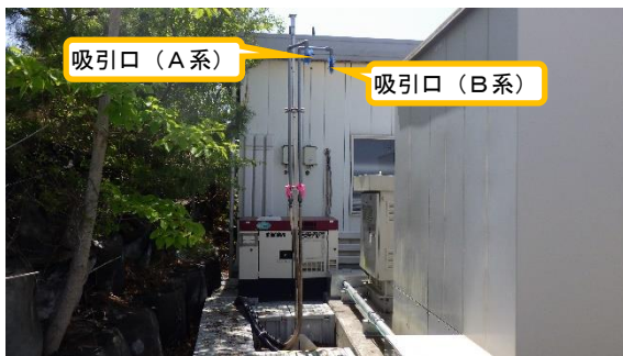
(写真2) 吸引口の設置状況 (シールド中央制御室前)
