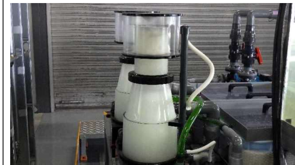
(写真2) ファンや食べ残しを除去するプロテインスキマー
