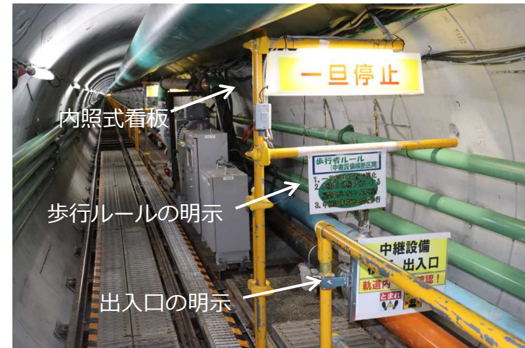
中継ポンプ設備区間における安全設備
