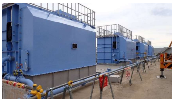
(写真1-1) スクリーン設備の地上部の様子
