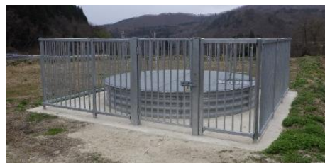
◀ 設置された集水井
