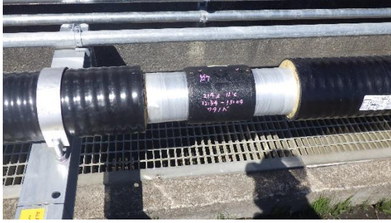
(写真3) 使用前検査対象の配管の繋ぎ目の一例
