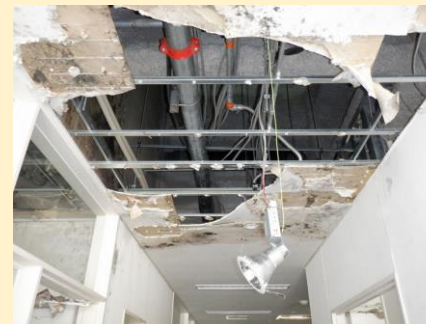
天井漏水跡、仕上材剥離
