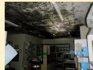
内壁・天井カビ発生
