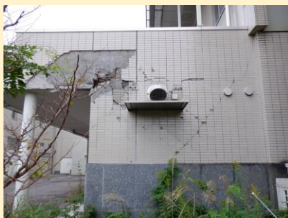
タイル浮き・クラック・剥離
