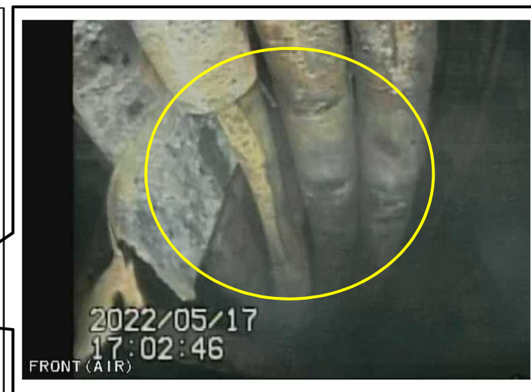
写真2. D/W内配管の状況
