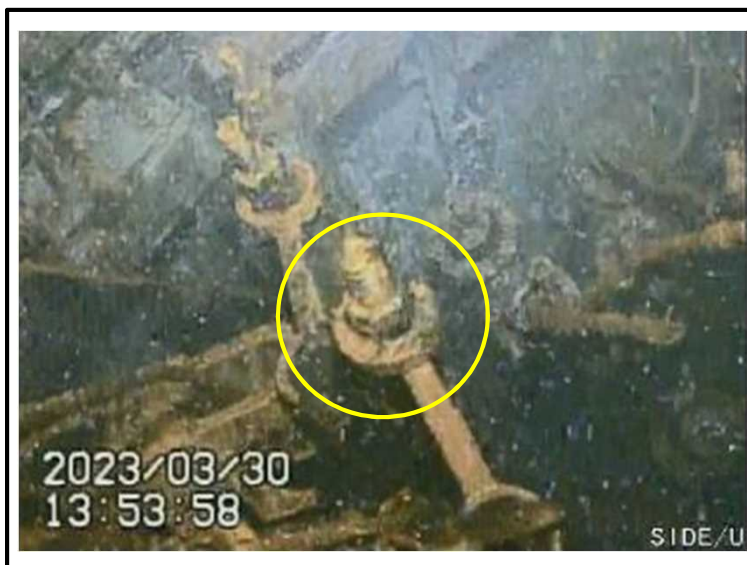
写真1. CRDサポートロッドの状況
