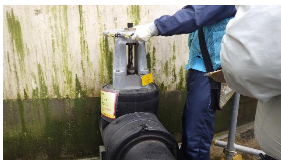
（写真6） タンク（B）以外の出口弁「閉」の確認状況
