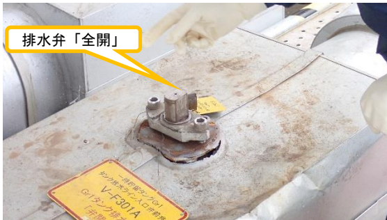
(写真3-2) グループ1排水弁の「全開」状況
