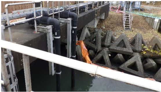
(写真 9) サブドレン処理水排水口の状況
