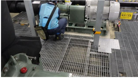
(写真 8) 浄化水移送ポンプ起動後の確認状況
