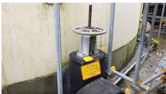
（写真7-2） タンク（B）の出口弁「開」状況
