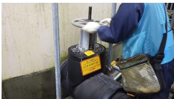
（写真7-1） タンク（B）の出口弁「開」操作状況
