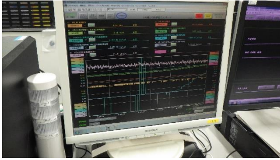
(写真1) プラントパラメータを監視するためのディスプレイ
