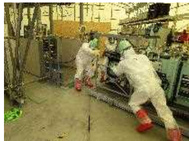
堆積物除去装置 （低圧水）設置
