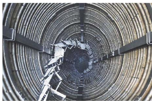
「 しゅうすいせい 集水井」内部 あがつ 揚津地区（喜多方市）
