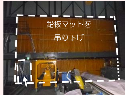
① 3号機側からの放射線を防ぐために、3号機側壁沿いに鉛板マットを設置
