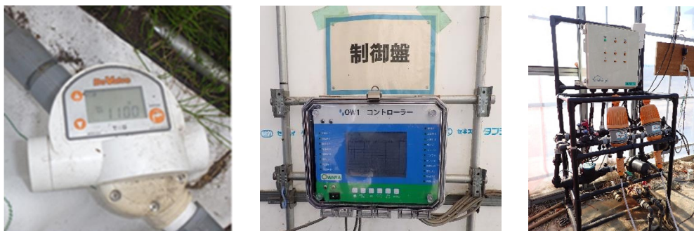
図3 かん水制御装置の例
