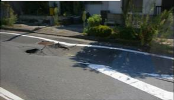
地震により陥没した道路
