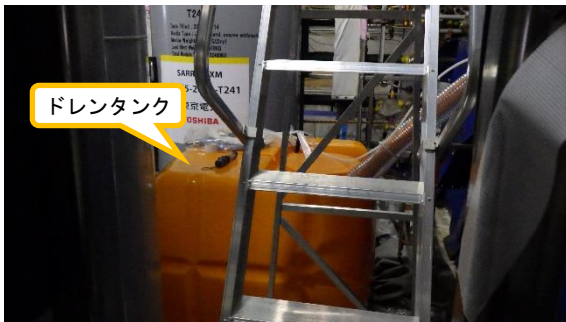
(写真2) ドレンタンク
