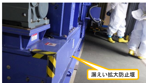
(写真5) 既設漏えい拡大防止堰
