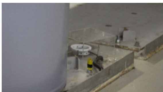
(写真4③) 漏えい検知器
