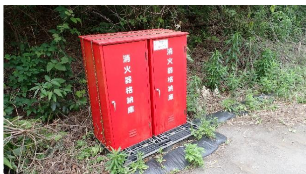
(写真4-3) 入口付近に設置された消火器
