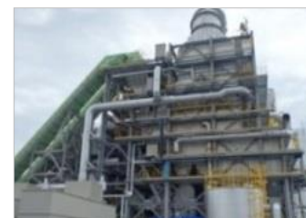
仮設焼却施設
