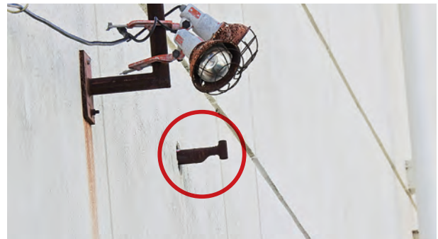
放射性物質を含む水が漏えいした配管 (左の写真を拡大)
