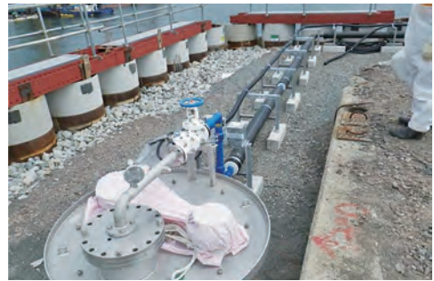
海側遮水壁と地下水ドレンpond
