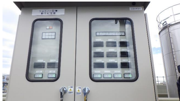
(写真1②) 制御盤
