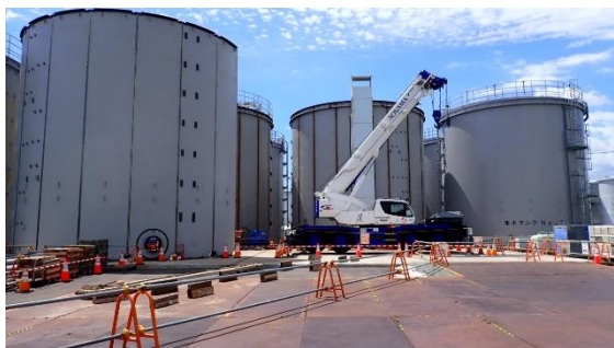
(写真1) サブドレン集水タンク設置工事現場 の概観（北側から撮影）
