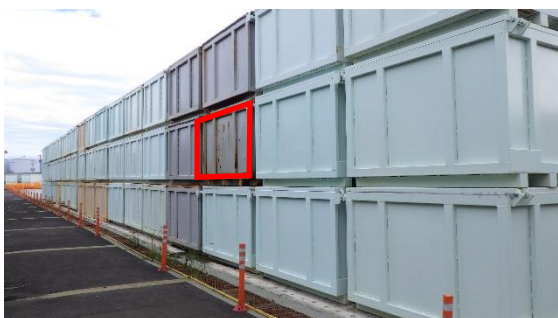
(写真2①) コンテナの腐食
