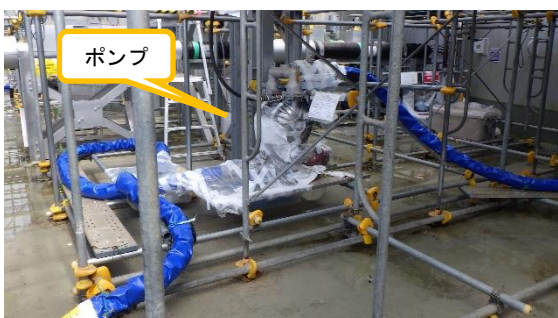
(写真3-1) 堰内の状況 (ポンプや耐圧ホースはタンクの残水移送に用いられる。)
