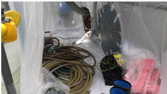
(写真4-2) 装備着脱用ハウス内の状況 (C4タンク)
