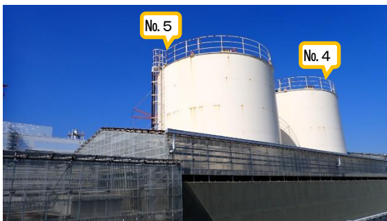
(写真1-2) 集水タンクNo.4~5 (2号機タービン建屋東側) (南東側から撮影)
