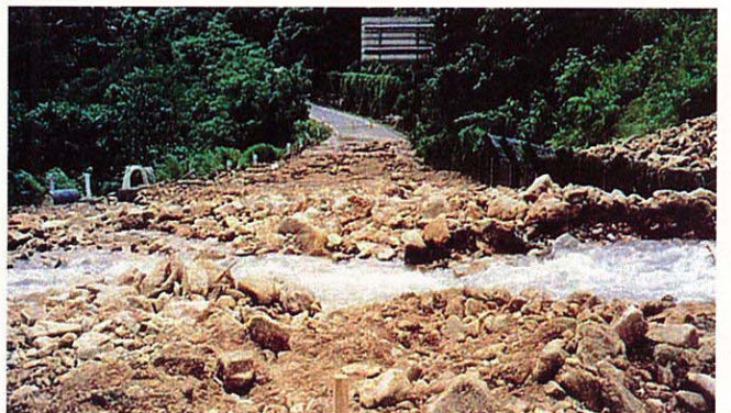
●(国)401号線 会津高田町宮川～昭和村小野川地内 (土砂流出)
