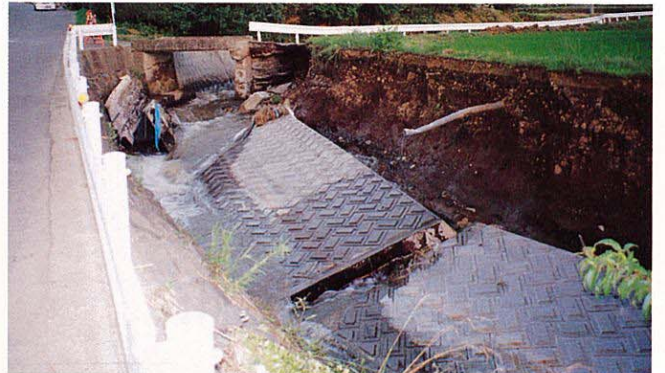
●(一級)くるみ川筋 福島市渡利地内 (護岸欠壊)
