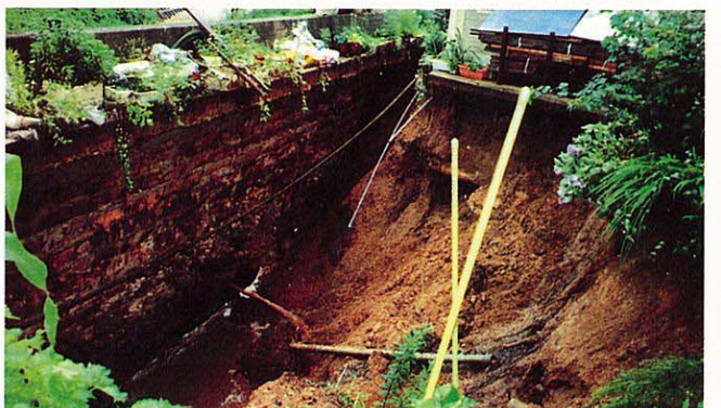
●(一級)銀山川筋 河沼郡柳津町大字柳津地内 (護岸洗掘)
