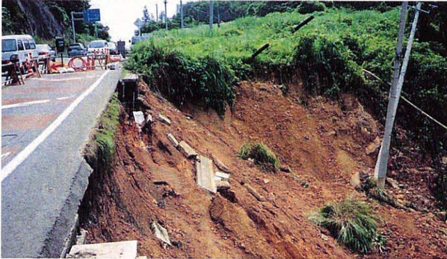
●(国)115号 福島市山口字行部地内 (路肩崩壊)
