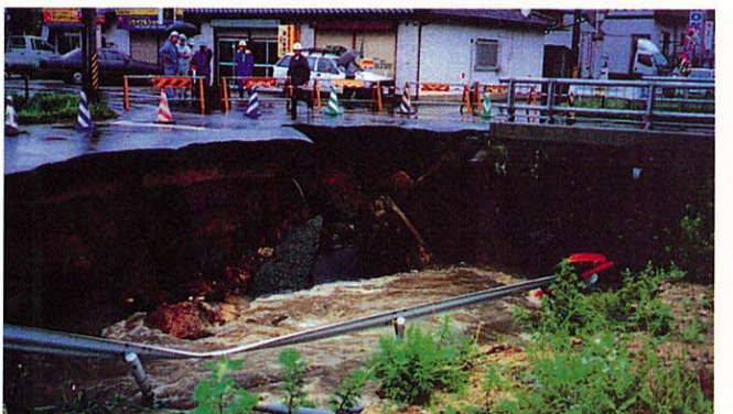
●(一級)南川筋 郡山市安積町日出山地内 (橋梁洗掘)
