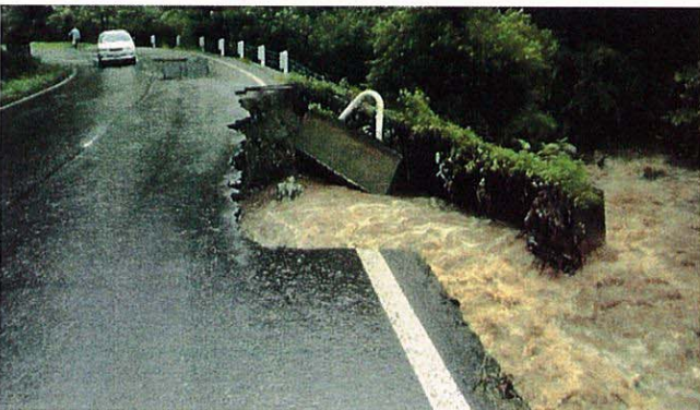
●(一)湯野上会津高田線 下郷町大字湯野上地内 (路肩崩壊)
