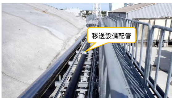
(写真2-1) 移送設備配管の状況①
