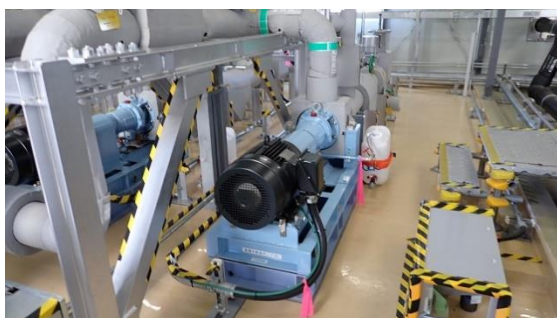
(写真1) ALPS 処理水移送ポンプ (B) の 状況
