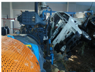
○排水機場内被災状況
