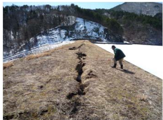
ため池堤体被災の様子
