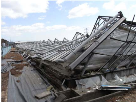
大型園芸ハウスの被災の様子
