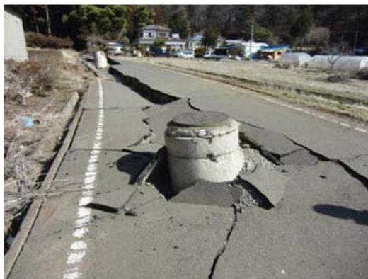
農業集落排水施設の被災の様子
