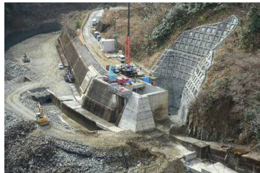
高柴ダム発電所（更新中）
