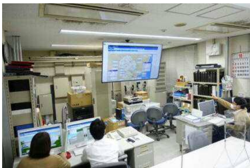
統合管理システム
