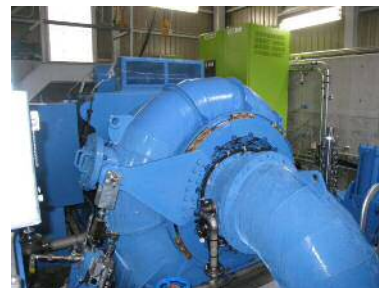
四時ダム発電所内部(水車)
