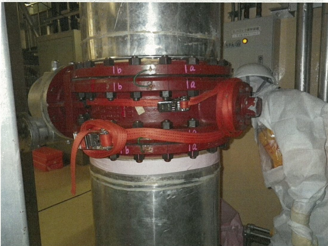
1 水漏れした配管
