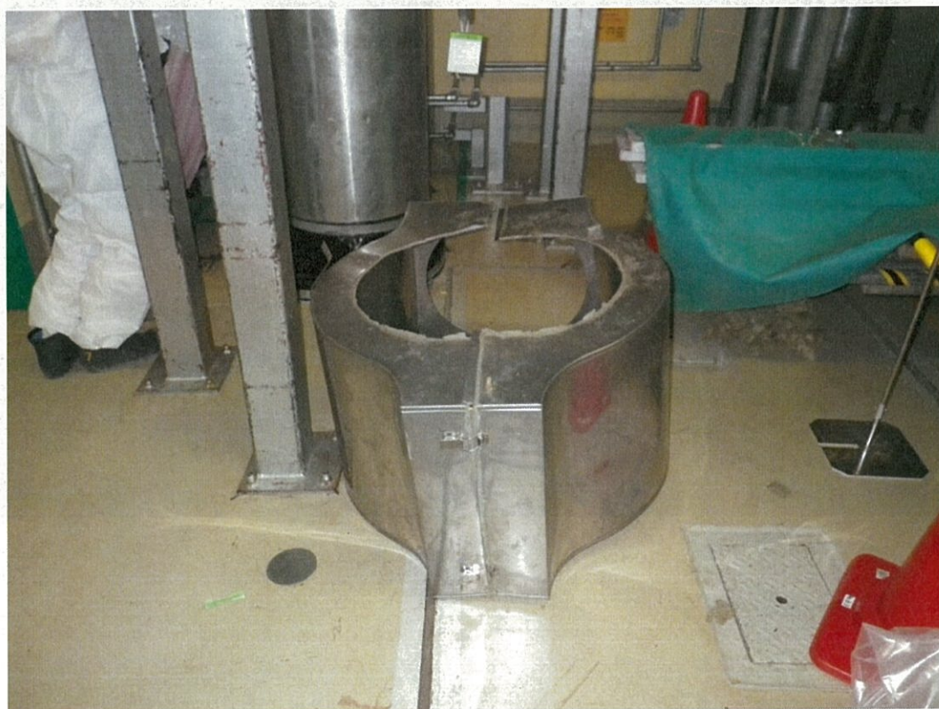
3 水漏れした配管の保温材カバー
