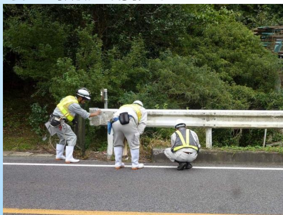
路面の損傷確認状況
