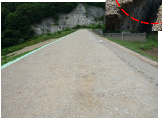
今は復旧して、亀裂も段差もなくなっています。
