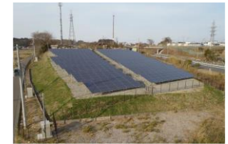
写真：太陽光発電所
