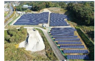
写真：太陽光発電所
