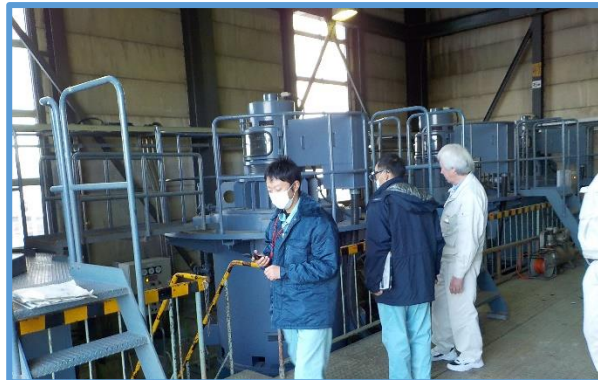
(小名浜ポンプ場ポンプ室)
