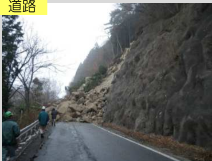
白河羽鳥線の被害状況(3/15)
