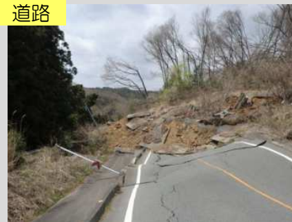
いわき石川線の被害状況(4/12)
