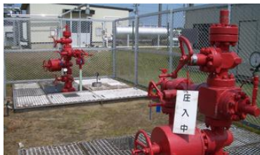
新潟県 紫雲寺鉱場 天然ガス地下 貯蔵井
