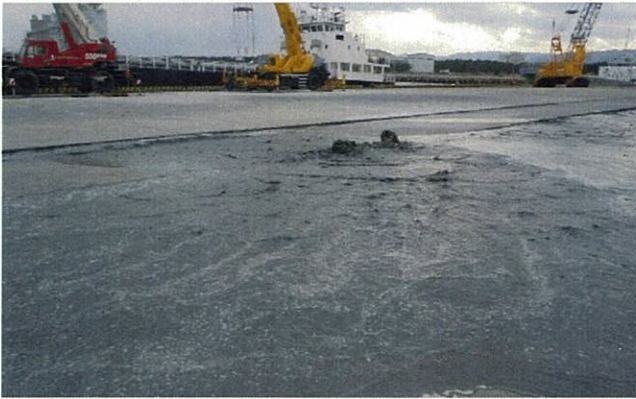
<地震発生後:2号ふ頭液状化の状況>
