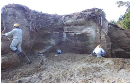
岩肌の床面を出す前の尾根付近の一部の様子です。安全確保のため必ずヘルメットを着用します。（浪江町大平山）
